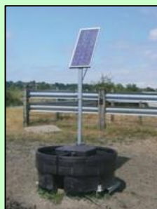
Abreuvoir solaire implanté en bordure d'une zone humide (pas de piétinement ni de déjection dans la zone humide).
